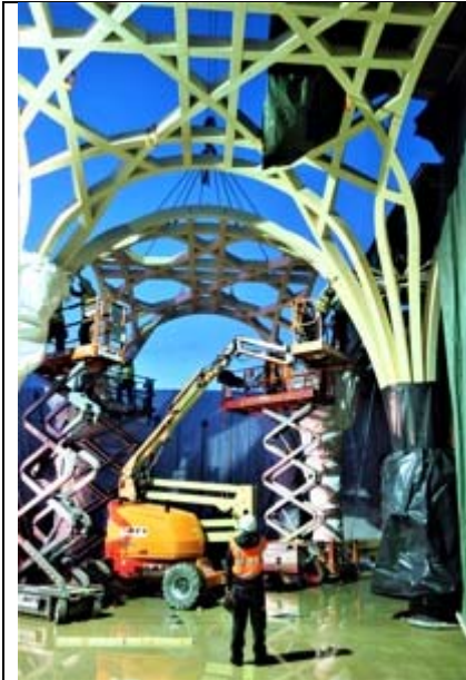
La structure en bois très sophistiquée se compose de 3800 pièces. ©Blumer-Lehmann AG
